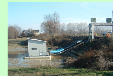
Impianto sollevamento Pievevita (PC)
